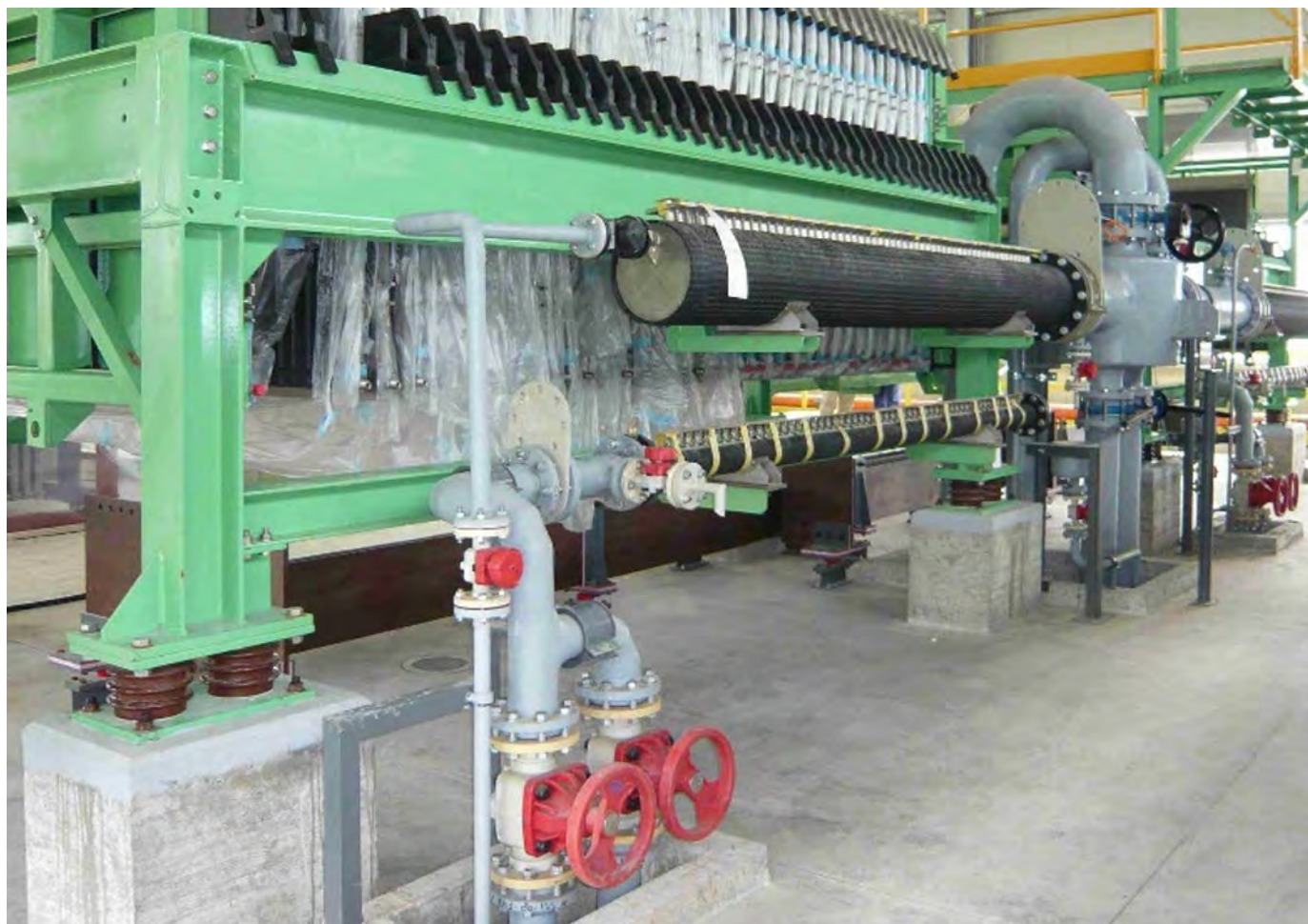
Figura 3 - Impianto cloro soda tubazioni di PVC-C e PP
