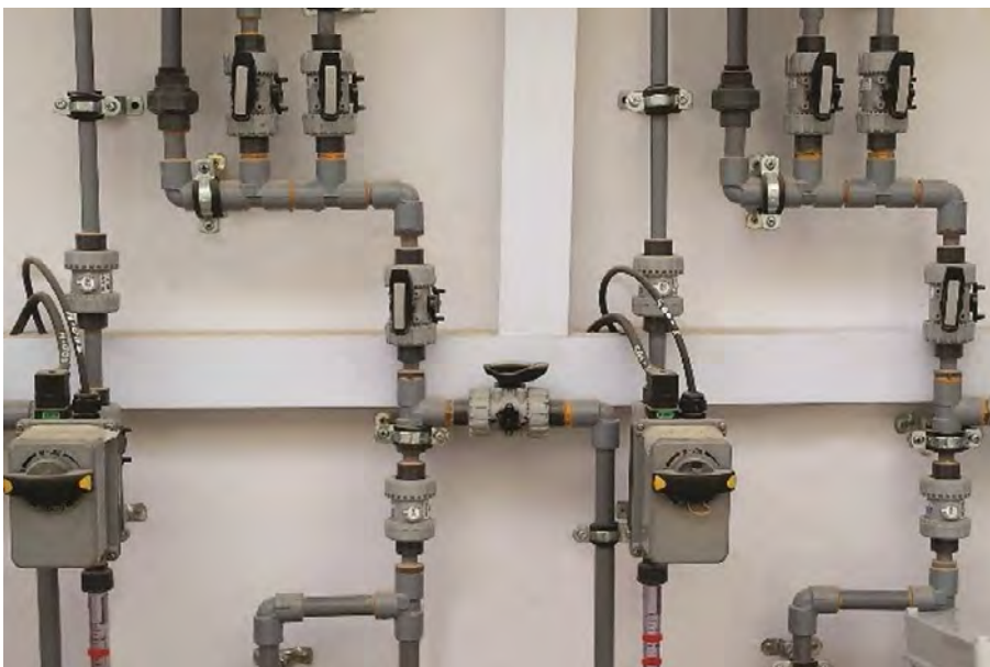
Figura 4 - Impianto per dosaggio chimico per pretrattamento acqua di mare in PVC-C
