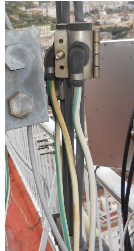
Particolare : scaricatori per cavi di collegamento antenne
